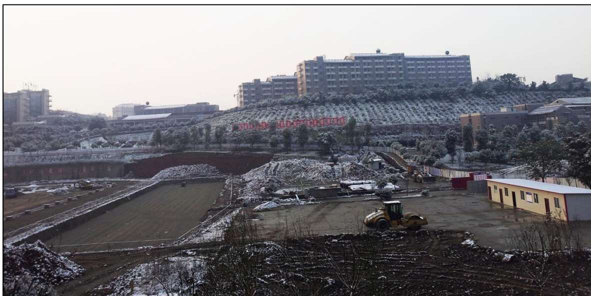
2016年1月24日，运动场及篮球场改造工程（局部）和西看台工程形象进度
